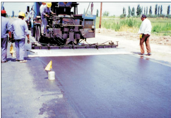
TRATAMIENTO DE SLURRY
